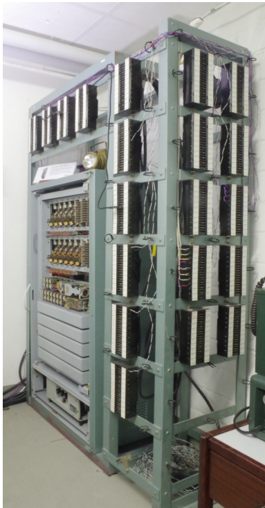
Der HVT am Aufstellort mit eingeschobener Telefonanlage
